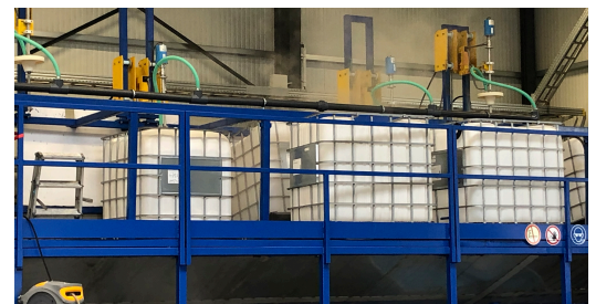
Nueva línea de lavado de IBC
